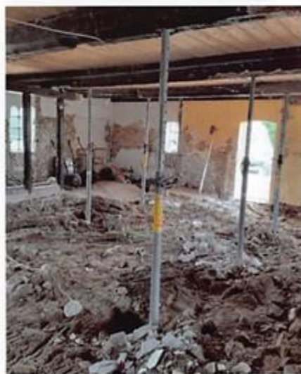
Morsche Balken mit übermaltem Bauschaum und Entkernung im ehemaligen Stall
